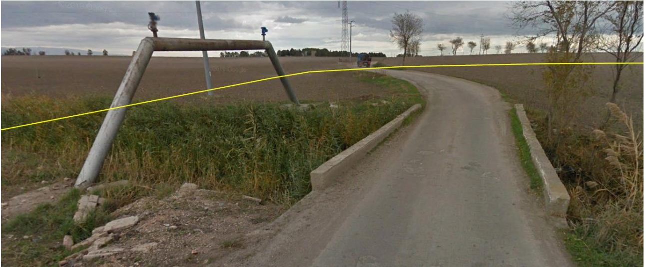
Figura 2-2: Interferenza elettrodotto con il Torrente Laccio
