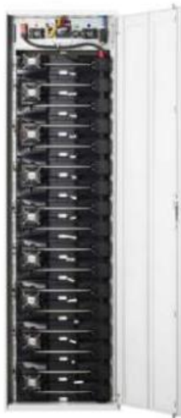
Figura 14: Esempio rack batterie
