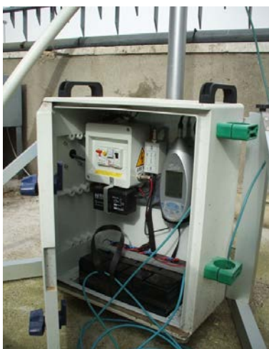
Fotografia interno centralina di rilevamento fonometrico SCS 9003.
