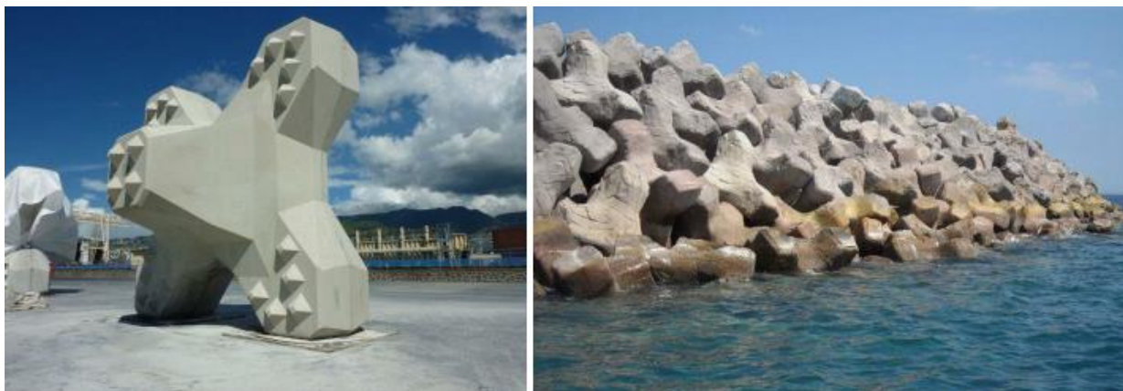
Figura 4.5 - Mantellata single-layer in massi artificiali tipo Ecopode™ (dx, parti emerse) e tipo Accropode™ (sx, parti sommerse).
