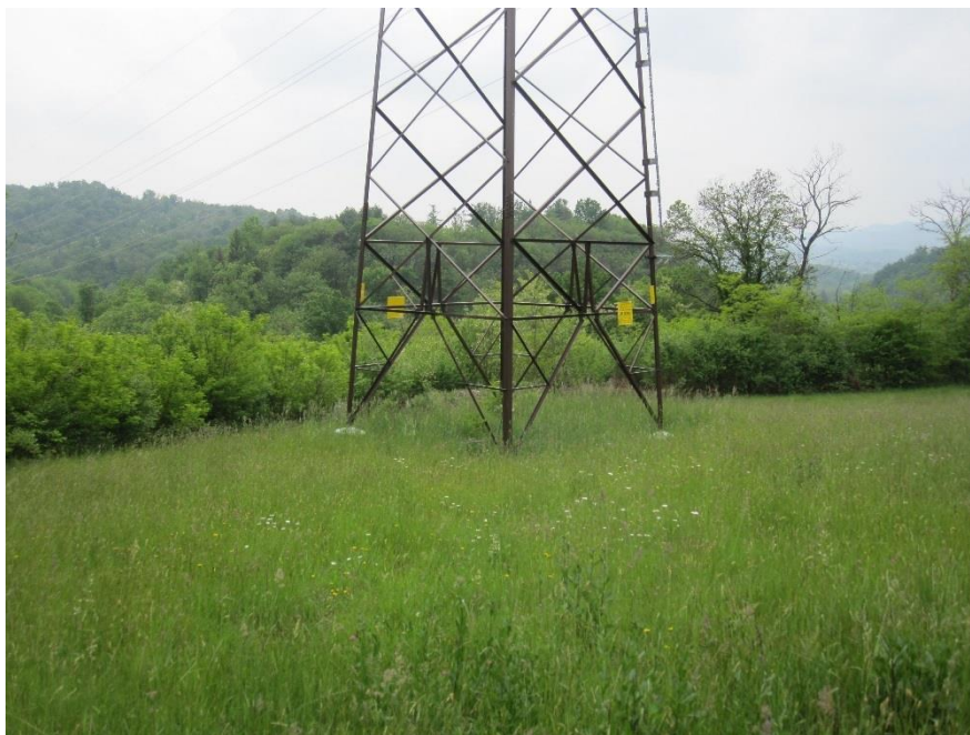
Figura 8-4 Intervento di inerbimento sulle linee 132 kV della Val D'Ossola Sud
