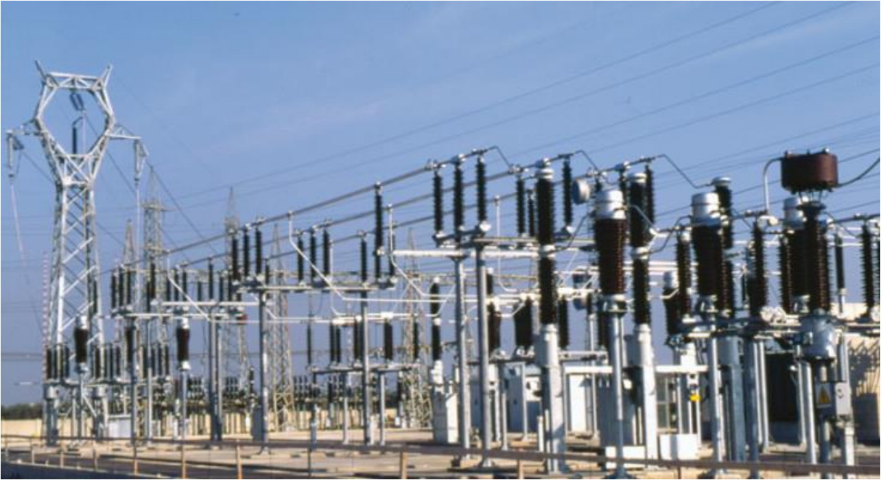
Figura 28 - Esempio di aspetto di stazione AT RTN - fonte Web, free license
