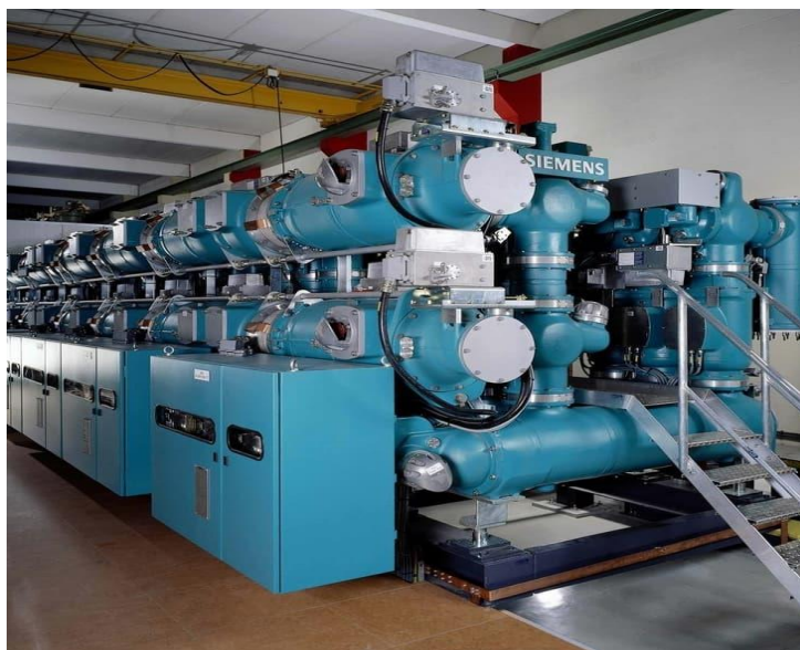
Figura 17 - Cella AT 220kV in stazione Off-shore (fonte Siemens)
