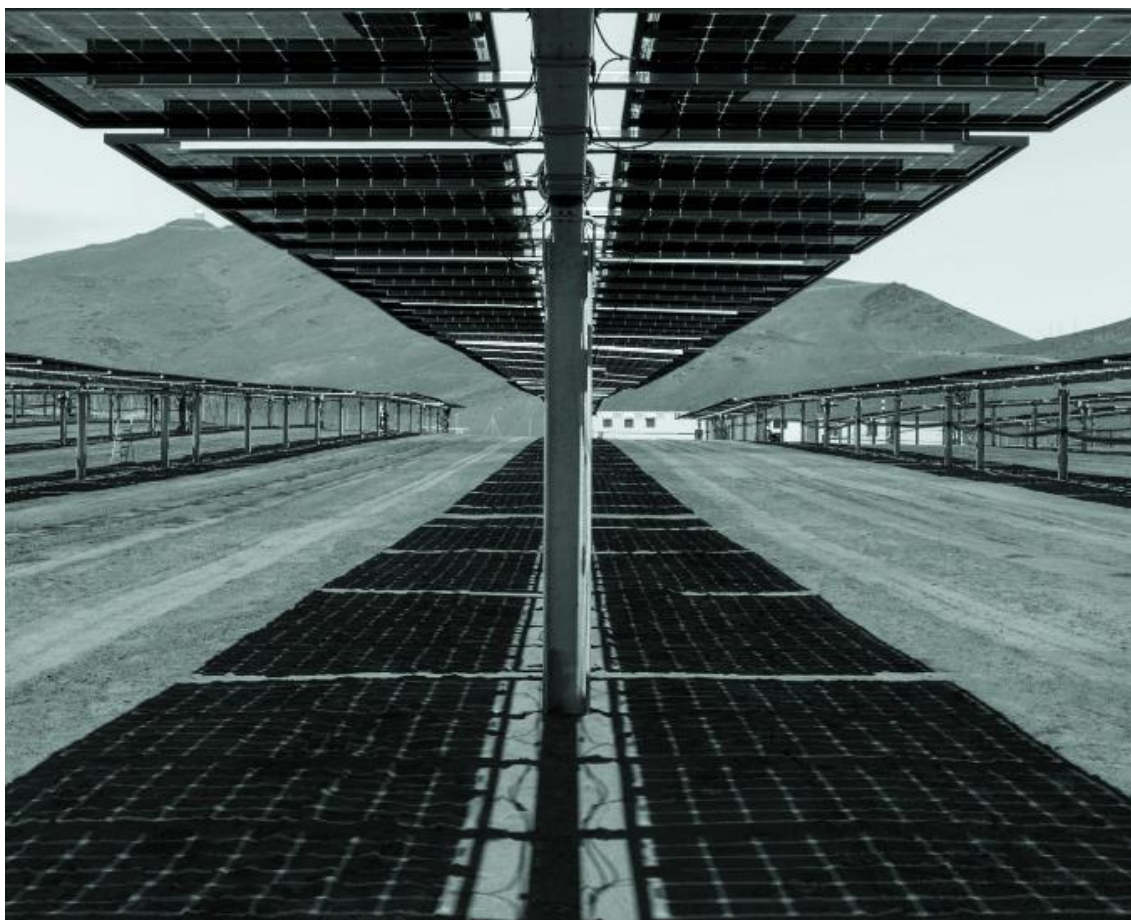
Foto 2: Superficie occupata dall'inseguitore monoassiale
