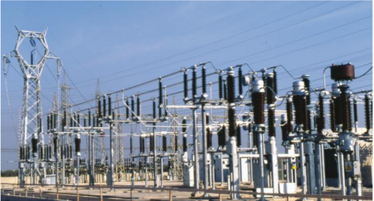
Figura 2-35 – Esempio di aspetto di stazione AT – RTN, (fonte Web, free license)
