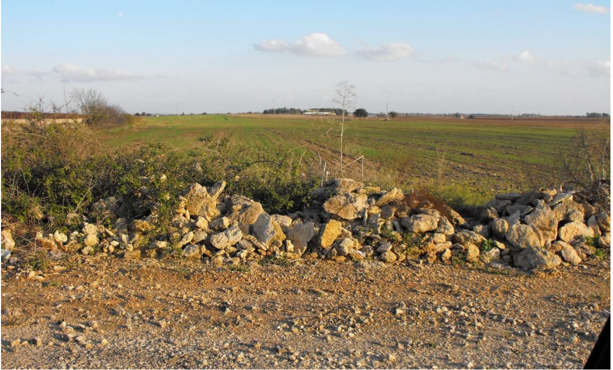
Figura 3-7: Muretto basso che necessita manutenzione a sud dell'area
