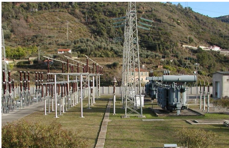
Figura 1.2: Esempio di sottostazione di trasformazione
