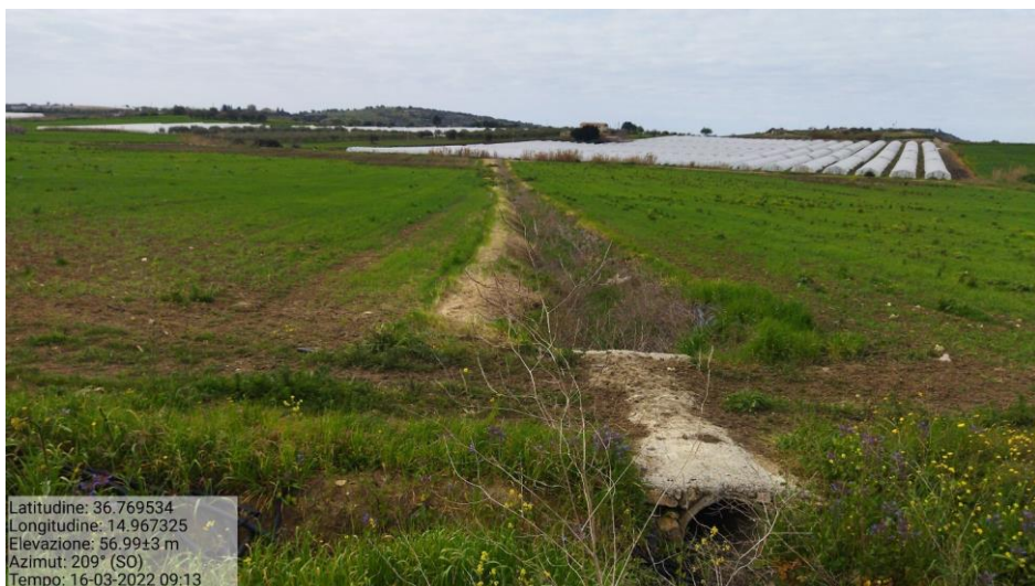
Figura 30: Canale ed attraversamento in monoblocco cementizio
