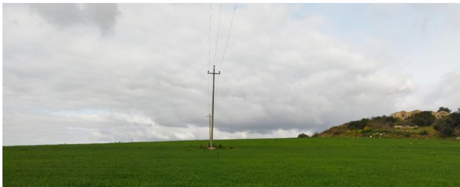
Figura 29: linea aerea di MT.
