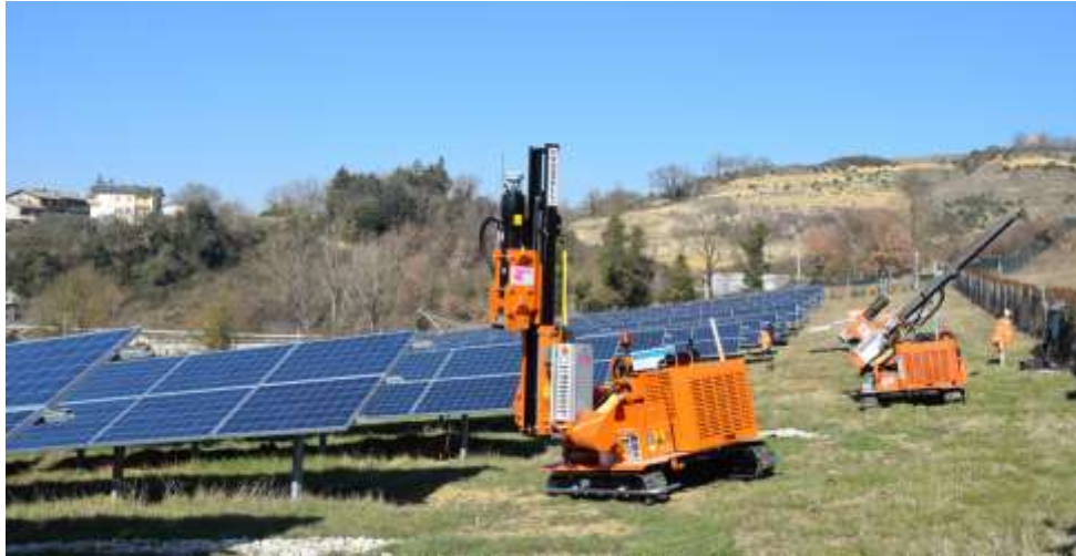
(Esempio di installazione di pali di fondazione mediante battipalo; tratto da Pauselli Group, sito web)
