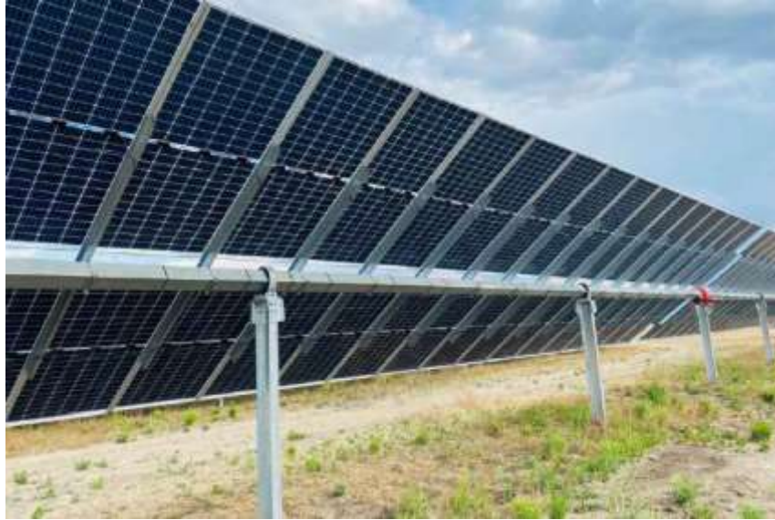
(Esempio di tracker monoassiale montante moduli bifacciali: si scorge in rosso il motore per la rotazione)
