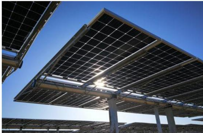
Figura 2.3:: Particolare strutture di sostegno moduli
