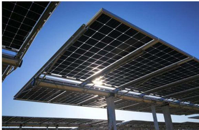
Figura 2.5: Particolare strutture di sostegno moduli
