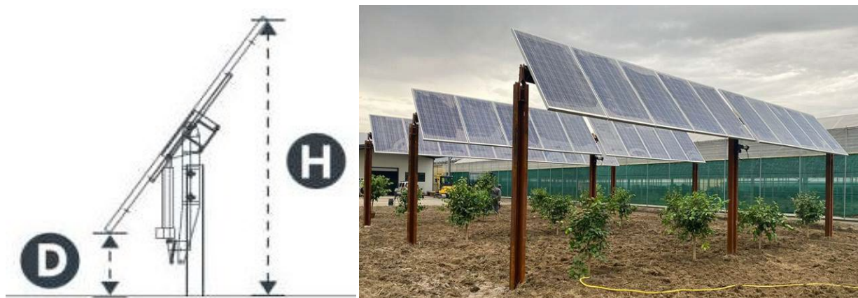
Figura 10 – Esempio di portale di sostegno dei pannelli fotovoltaici installati nel campo agrivoltaico.
