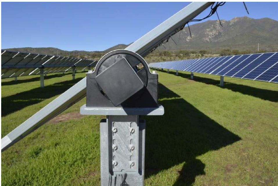
Figura 7 dettaglio del tracker ad inseguimento
