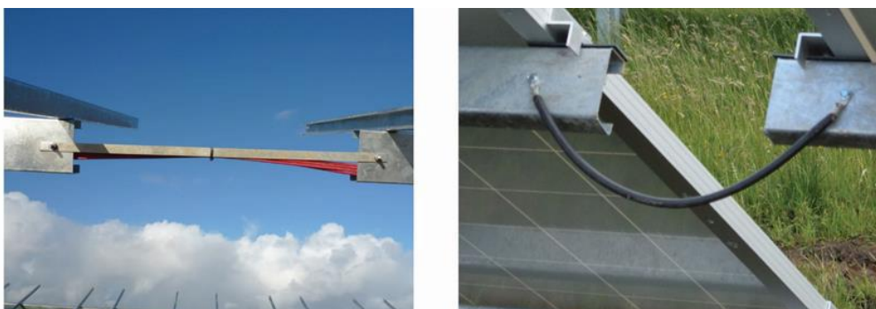
Figura 6: collegamento equipotenziale tra strutture adiacenti
