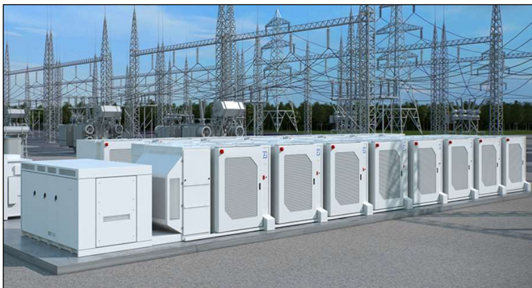
Figura 36: esempio di sistema di stoccaggio per impianto fotovoltaico - Gridstack
