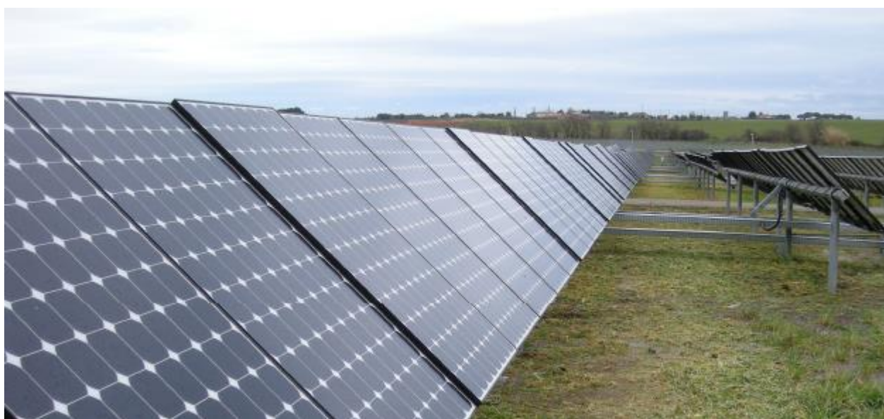
Figura 14 - Stato del terreno inerbito sotto i pannelli fotovoltaici
