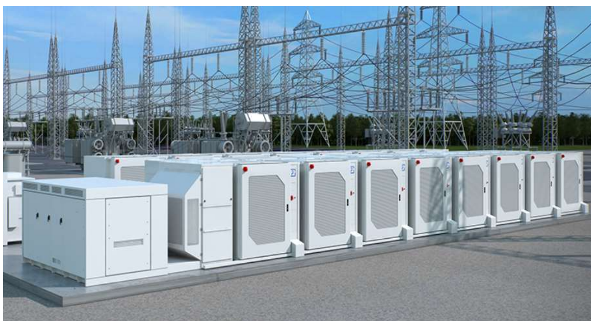
Figura 37: esempio di sistema di stoccaggio per impianto fotovoltaico - Gridstack
