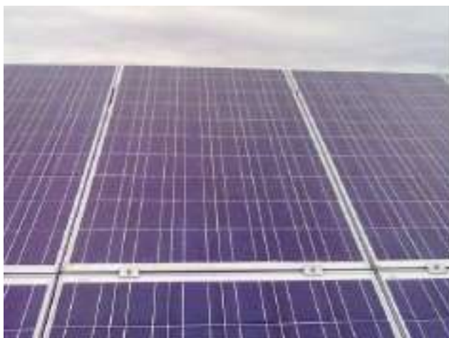
Tavola n. 21: Modulo con superficie compromessa
