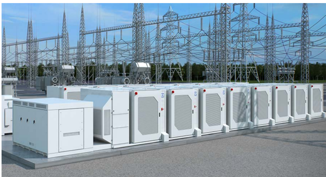
Figura 38: esempio di sistema di stoccaggio per impianto fotovoltaico - Gridstack
