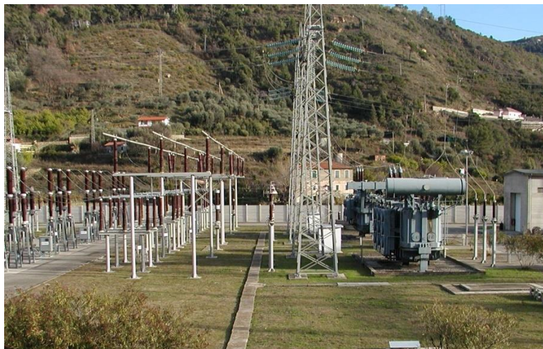
Figura 1.2: Esempio di sottostazione di trasformazione
