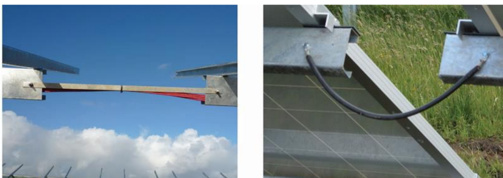
Figura 6: collegamento equipotenziale tra strutture adiacenti
