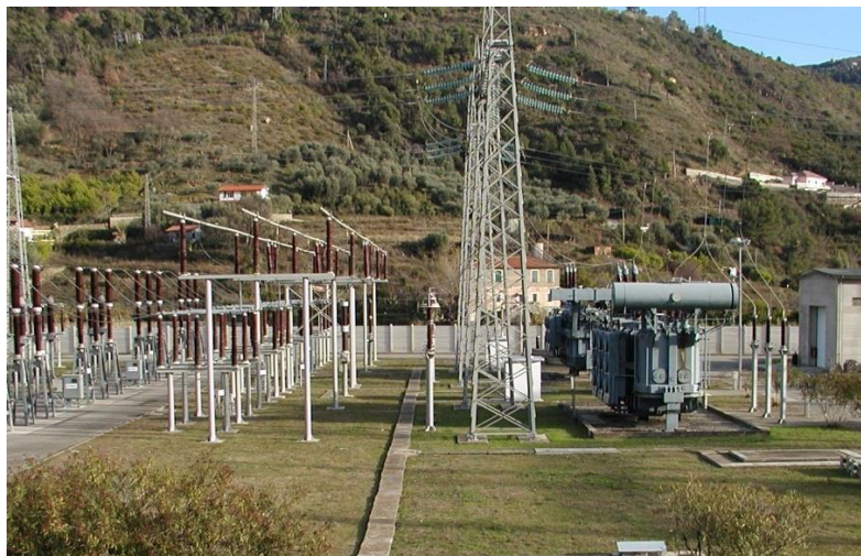
Figura 1.2: Esempio di sottostazione di trasformazione
