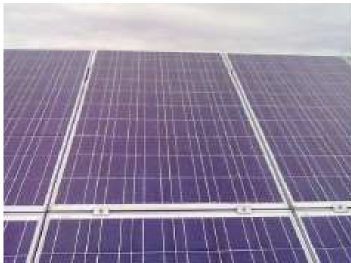
Figura 8.9 Modulo con superficie compromessa
