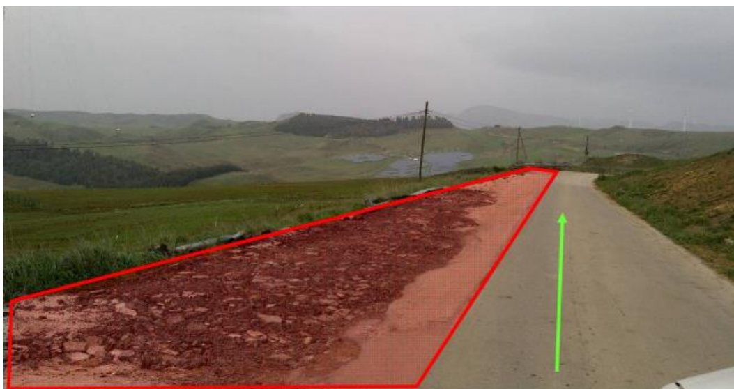
Figura 20: Esempio strade dissestate
