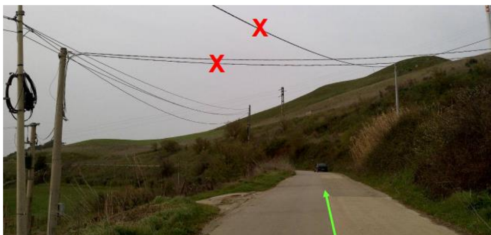
Figura 15: Esempio cavi elettrici o del telefono
