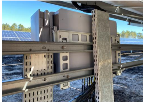
Figura 7: supporto per quadri elettrici
