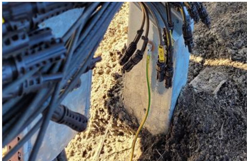
Figura 4: messa a terra
