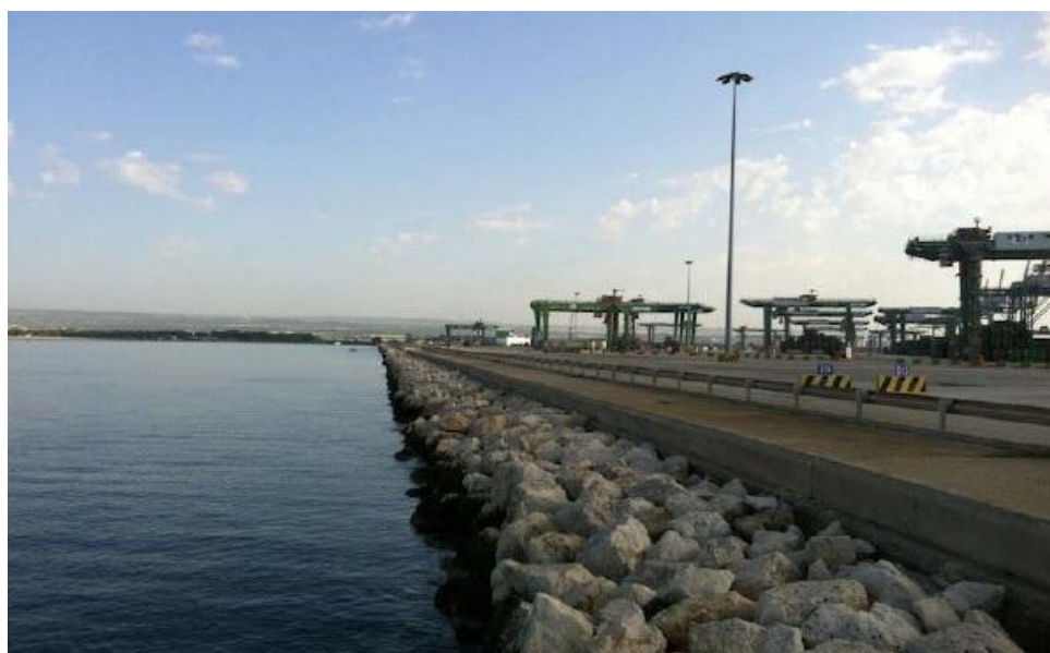
Figura 3.30 – Foto 9, Panoramica frangiflutti in pietra lato Nord molo polisettoriale, direzione fotografica NE.
