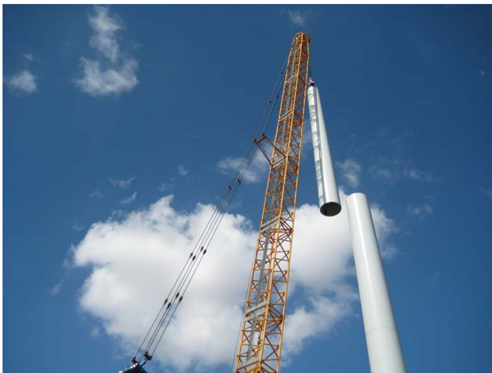
Figura. 60 – Attività di smontaggio degli elementi in acciaio di forma tronco-conica costituenti il sostegno dell'aerogeneratore
