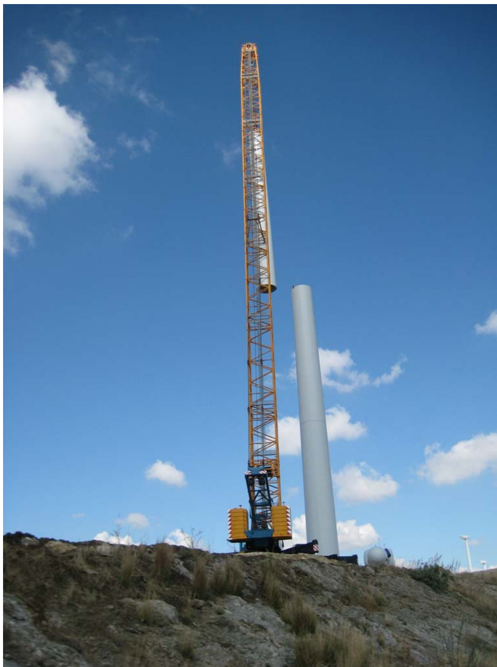
Figura. 20 – Attività di smontaggio degli elementi in acciaio di forma tronco-conica costituenti il sostegno dell'aerogeneratore
