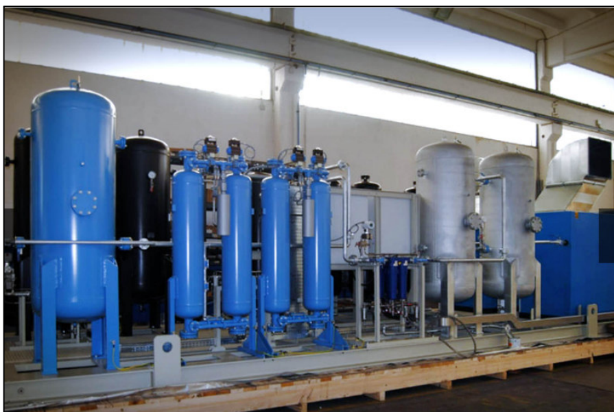
Figura 5-4 - Esempio installazione skid produzione azoto e aria strumenti
