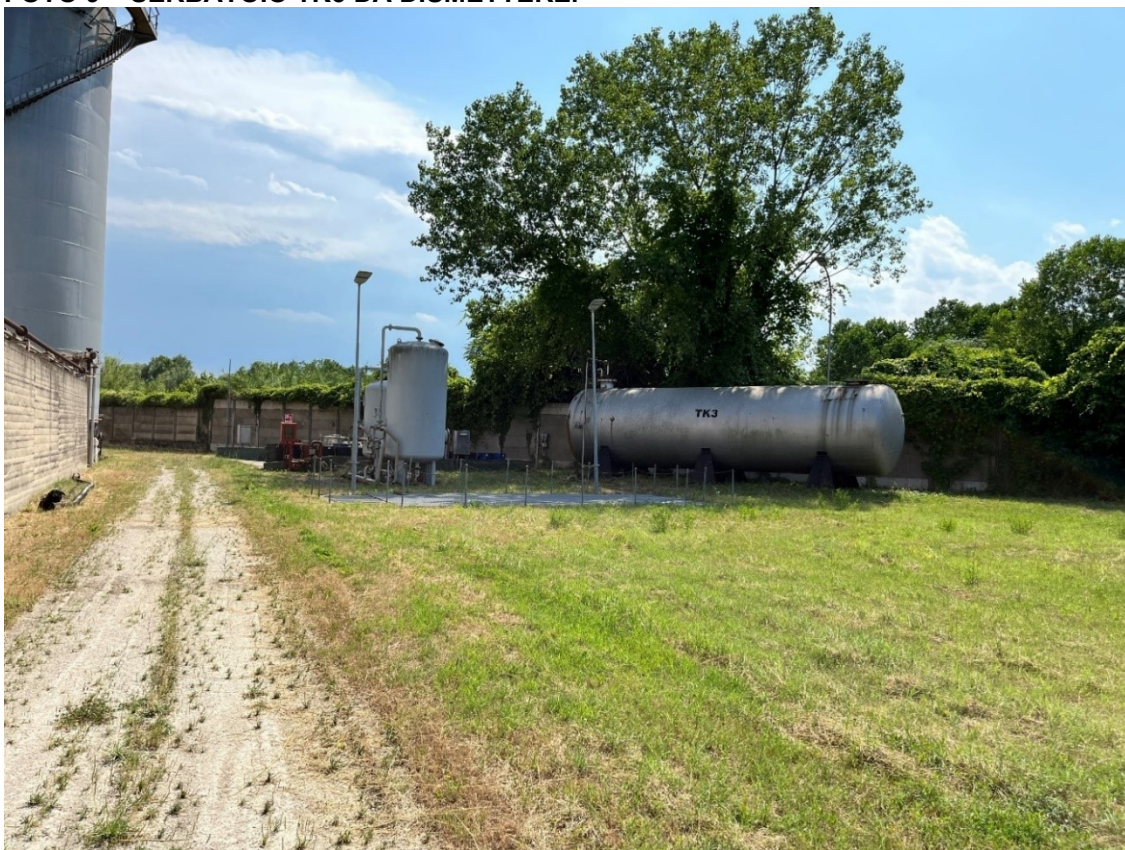
FOTO 9 – SERBATOIO TK3 DA DISMETTERE.
