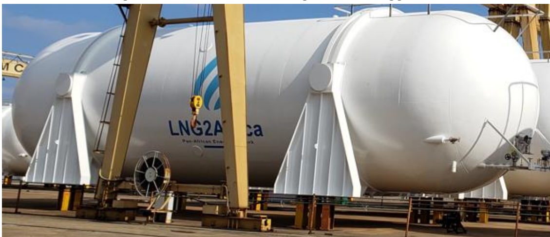
Figura 6-2 - Foto serbatoio criogenico stoccaggio LNG
