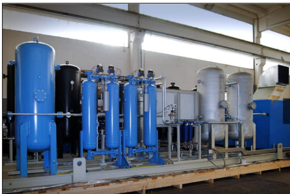
Figura 6-4 - Esempio installazione skid produzione azoto e aria strumenti
