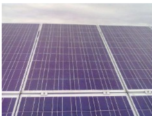
Figura 17: Modulo con superficie compromessa
