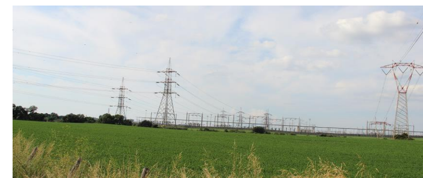
Figura 30: foto della stazione Terna di Montalto e dei raccordi aerei in uscita/ingresso
