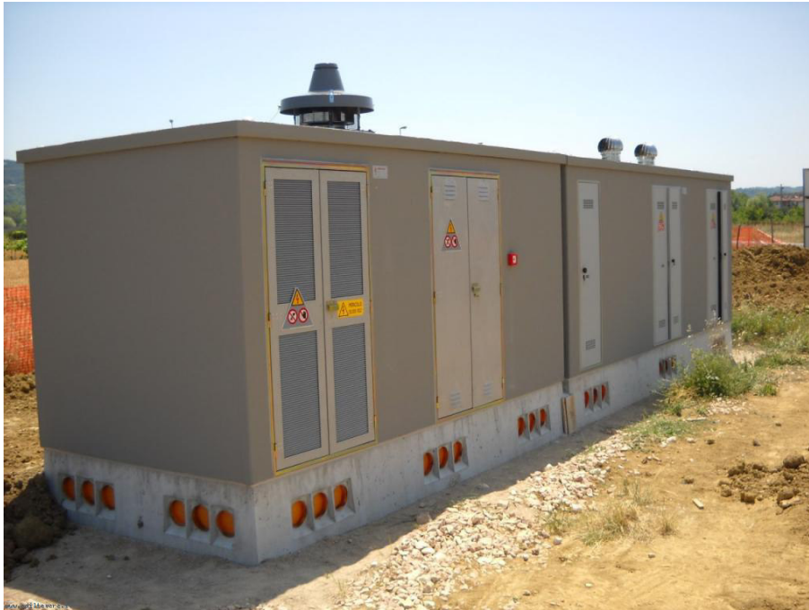
Figura 11. Tipologico delle cabine di conversione e trasformazione.
