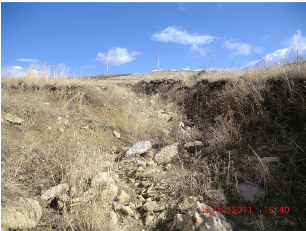
Figura 37: esempio di erosione fluviale nelle vicinanze del sostegno 130.
