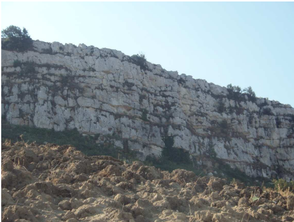
Figura 34: Crolli nelle vicinanze del sostegno 265
