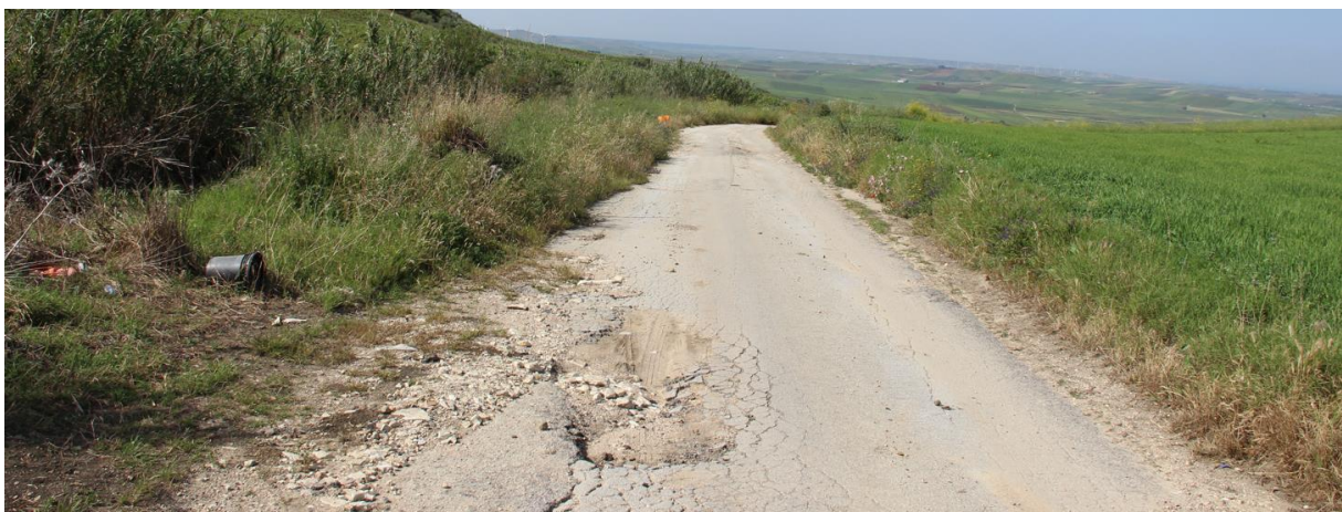
Figura 6 – viabilità locale che verrà utilizzata per raggiungere la posizione della A02 e, proseguendo, le torri A01, A03, A04 – tratto interessato da interventi di sistemazione del manto stradale e dalla posa del cavidotto interno
