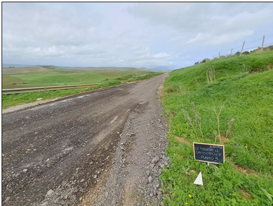
Fig. 28: Cavidotto esterno. Punto 3 – Tratto I
