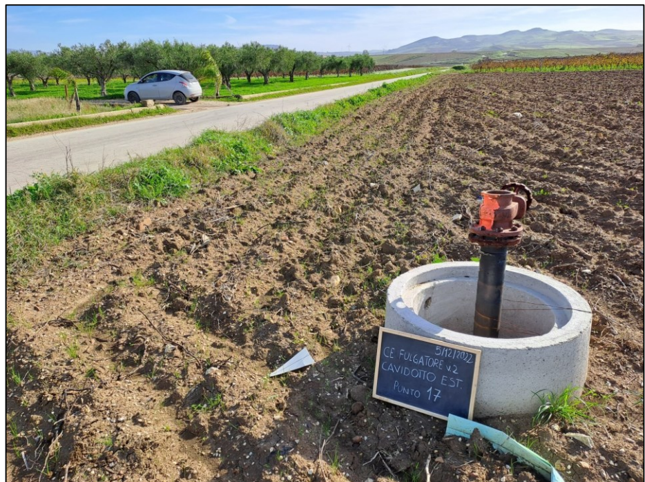
Fig. 45: Cavidotto esterno. Punto 17 – Tratto VII
