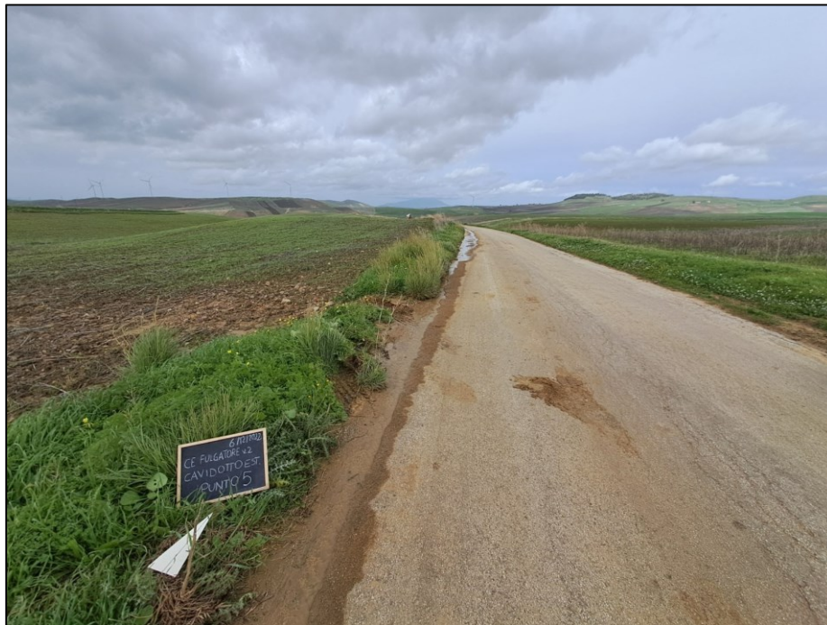
Fig. 30: Cavidotto esterno. Punto 5 – Tratto I
