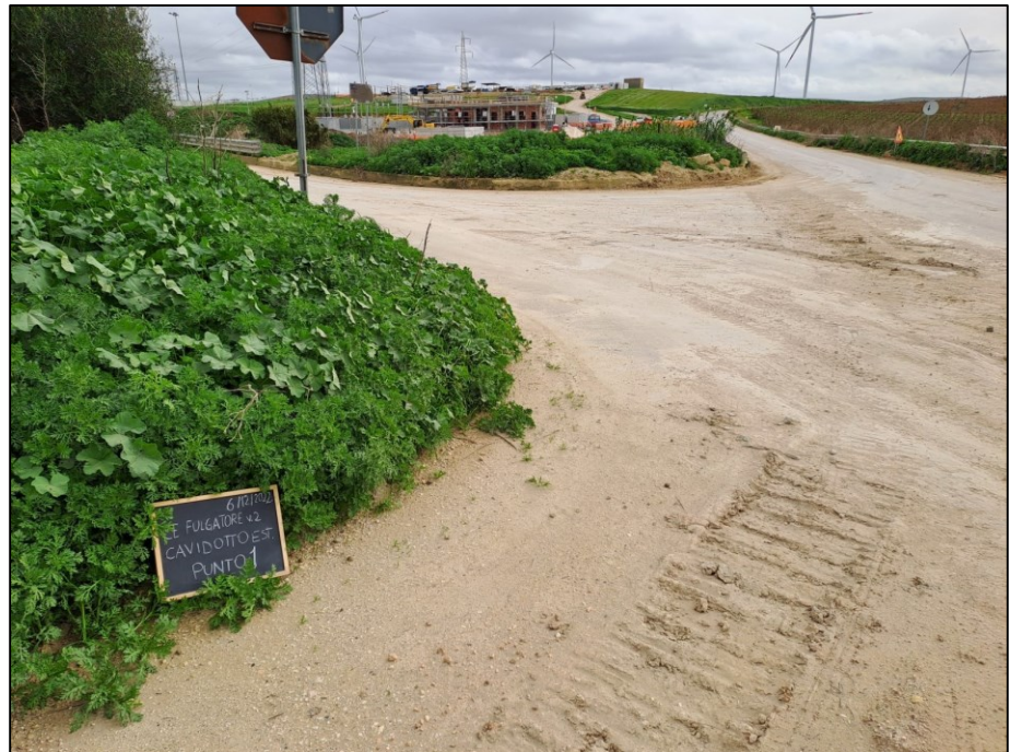
Fig. 26: Cavidotto esterno. Punto 1 – Tratto I
