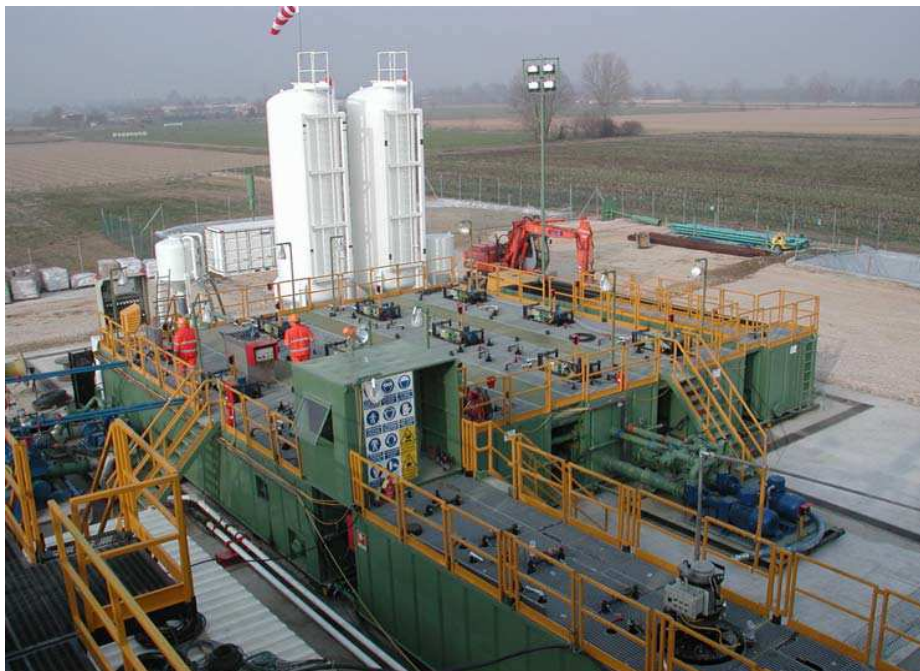
Figura 4-8: Vasche fango dell'impianto HH220
