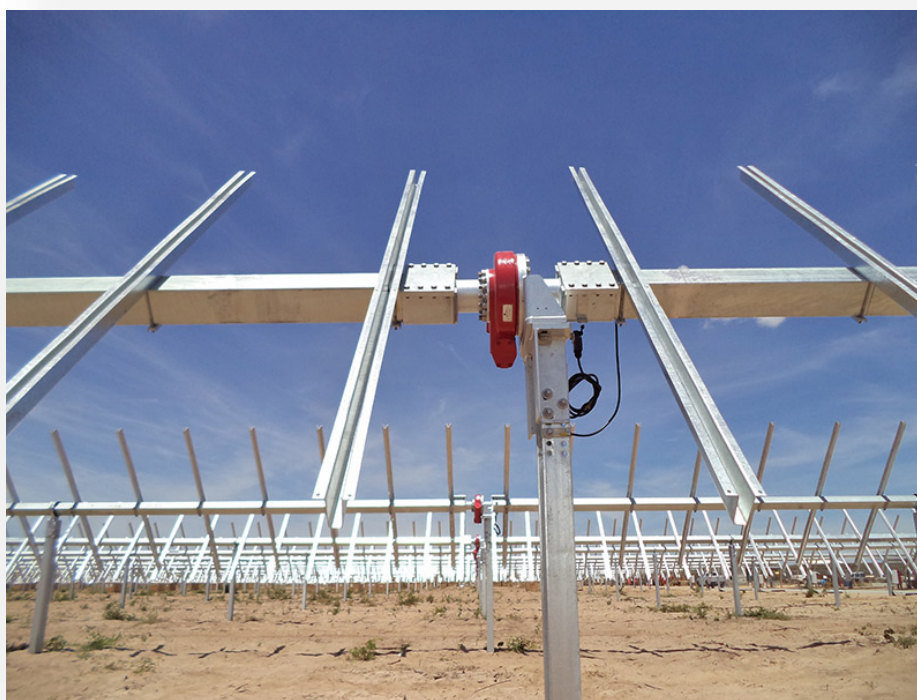
Figura 2 – Struttura dell'inseguitore solare monoassiale
