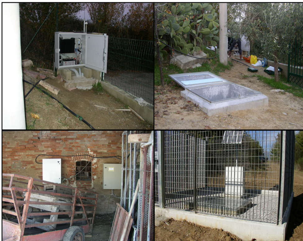
Esempi di tipologie di installazione postazioni microsismiche
