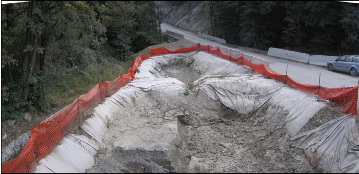
Figura 1.3.4.2/4 Sistema di due vasche presidio di raccolta-decantazione delle acque di cantiere disposte in serie a monte del recapito sulla rete naturale (corso d'acqua in corrispondenza del ponticello). Le vasche sono state svuotate per effettuare la manutenzione periodica (asportazione del materiale sedimentato e sostituzione del geotessile).
