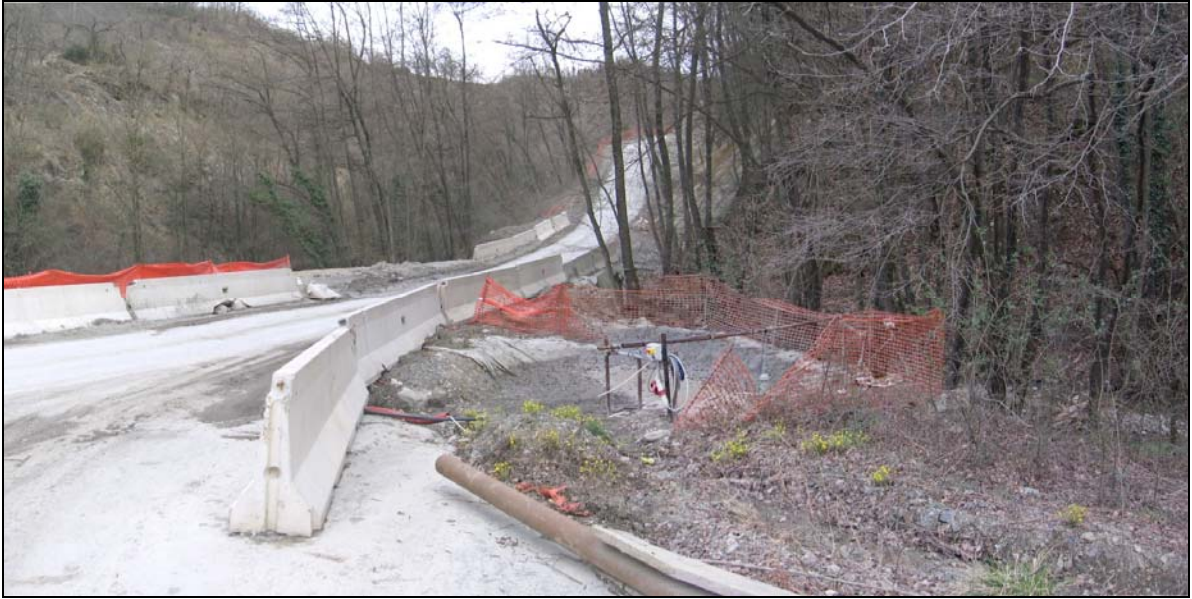
Figura 1.3.4.2/2 Vasca di raccolta/decantazione delle acque raccolte in un'area di cantiere immediatamente a monte del recapito in un corso d'acqua naturale
