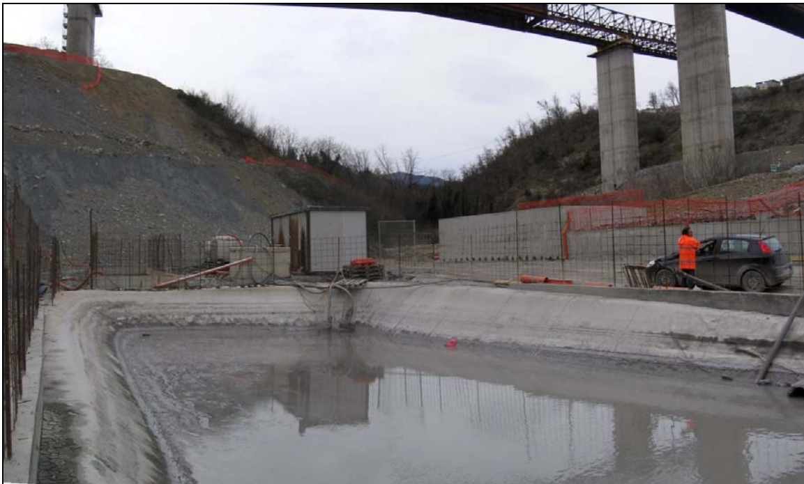
Figura 1.3.4.2/5 Particolare di vasca presidio: in questo caso la vasca viene utilizzata, oltre che per intercettare le acque di dilavamento delle aree di cantiere, anche per le acque di lavorazione
