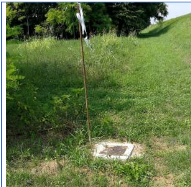
Figura 2.O: Panoramica area piezometro ASt04M
