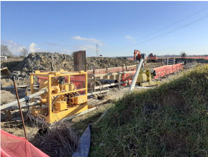
Vista pompe estrazione acqua
