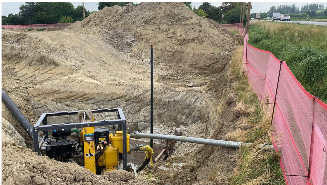
Vista pompa per l'estrazione dell'acqua
