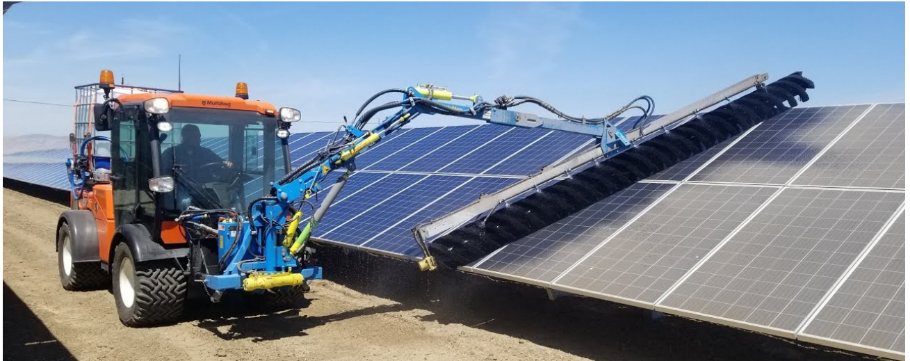
Figura 58 dettaglio lavaggio pannelli
