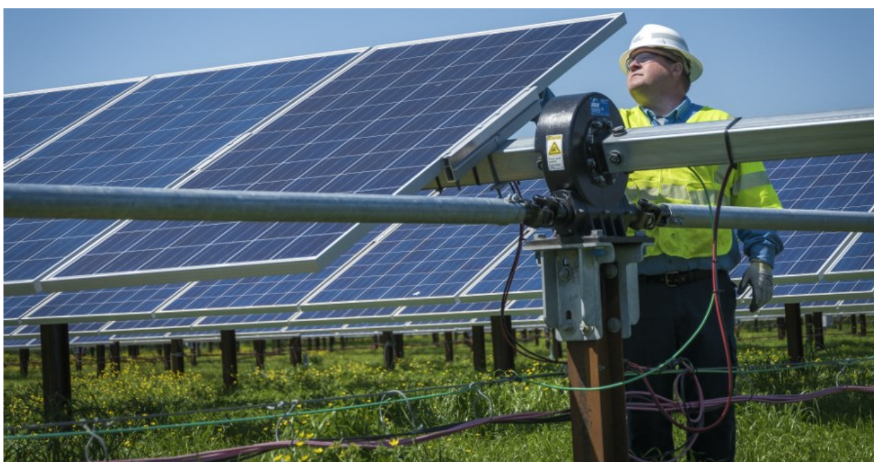
Figura 57 dettaglio manutenzione strutture tracker
