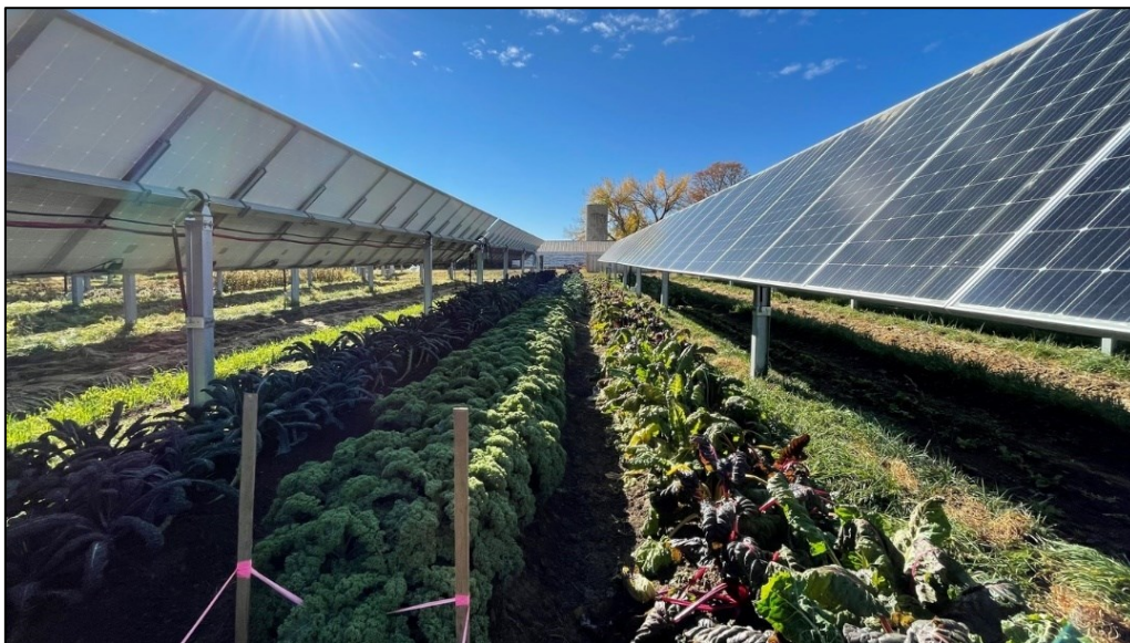
Figura 2 Esempio di impianto agrovoltaico
